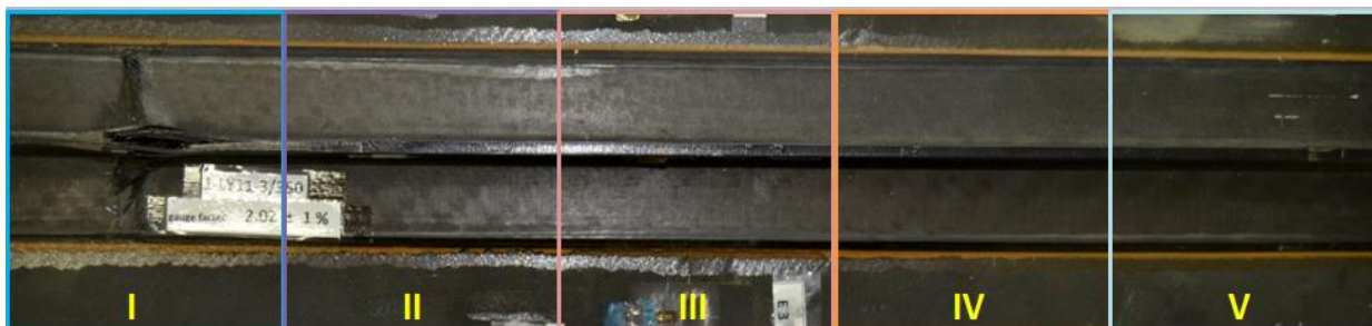
Figura 1. Divisão do painel para melhor localização da falha.
